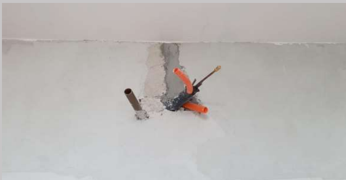
Ducteado y desague AA piso 1
