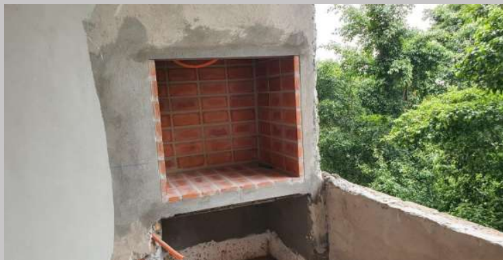
Revestido refractario en parrillas piso 1
