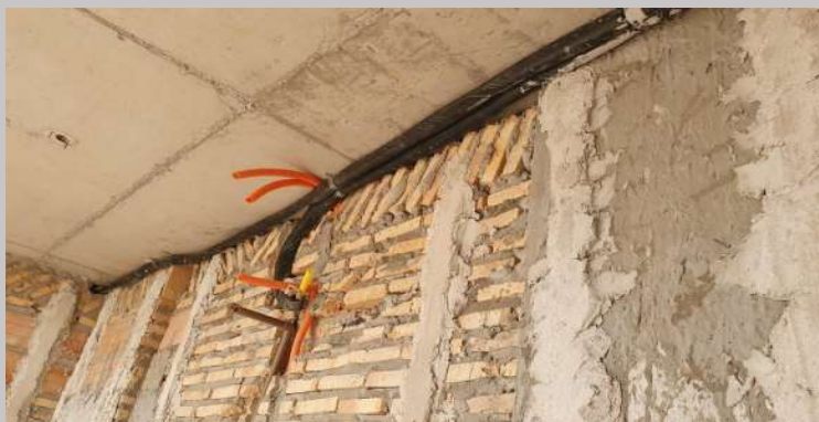
Ducteado para AA y sus desagües en piso 2
