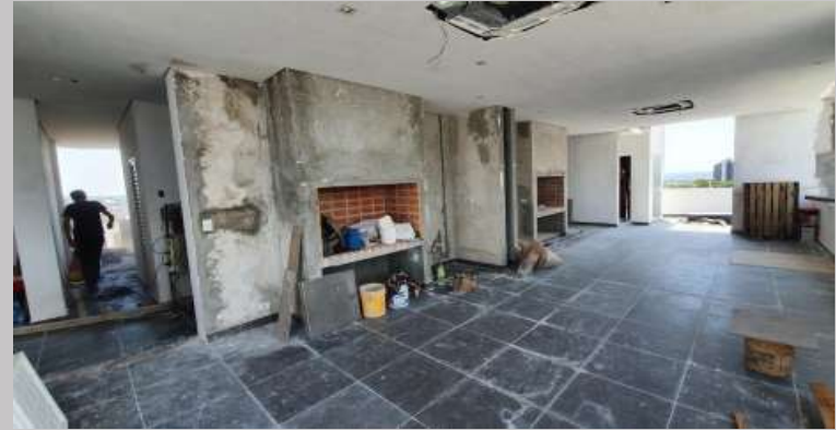
Vista actual de parrillas y terminaciones en el quincho
