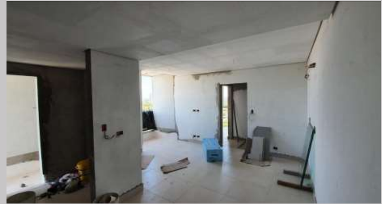
Piso y cielorraso en el 6D
