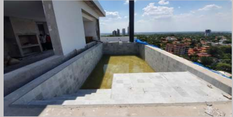
Vista de la piscina en azotea
